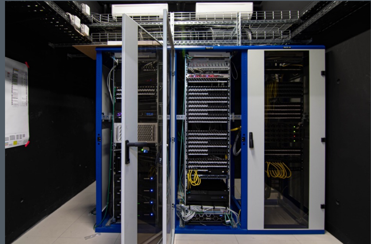
Sala de Equipamentos
