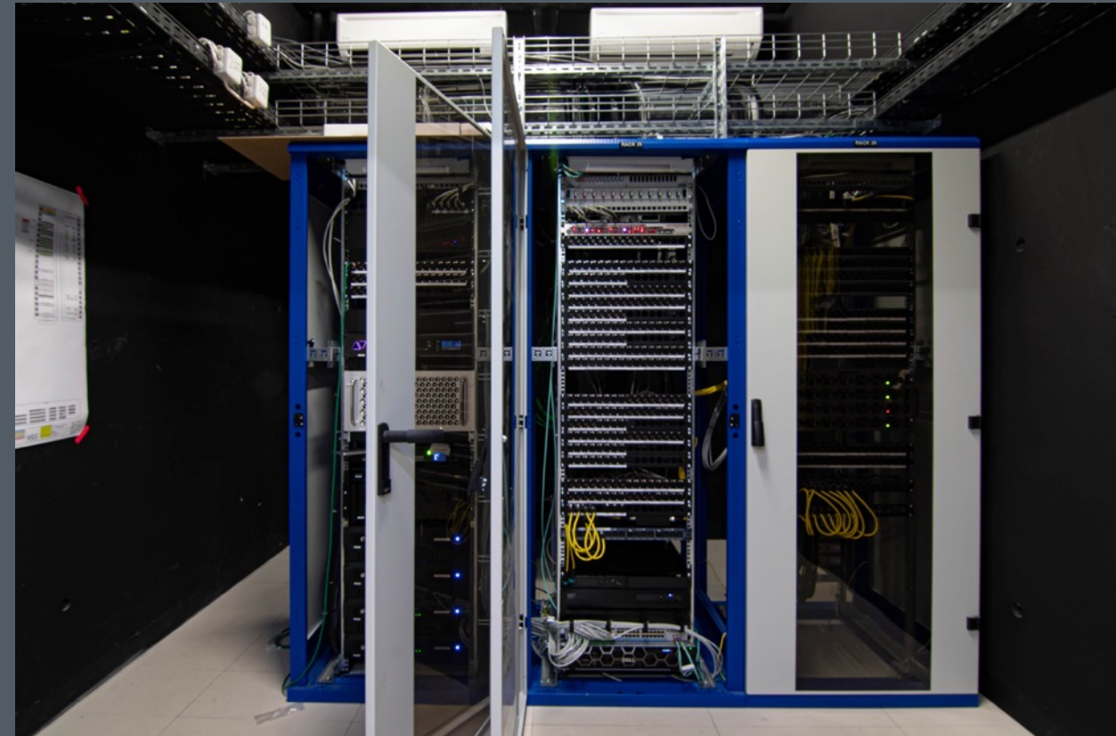
Sala de Equipamentos
